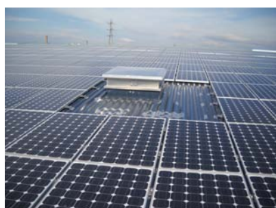
Module PV monté sur support métallique nécessitant une couche d'étanchéité sous-jacente
